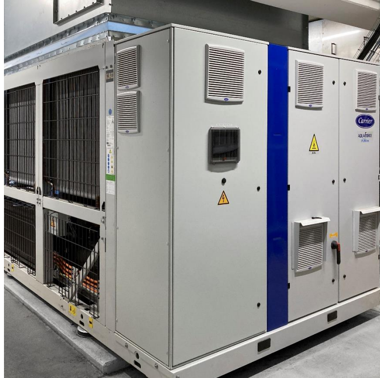
Hochmoderne Produktionsanlagen Industrielle Kälteanlage von Kuhn Group in Saverne
