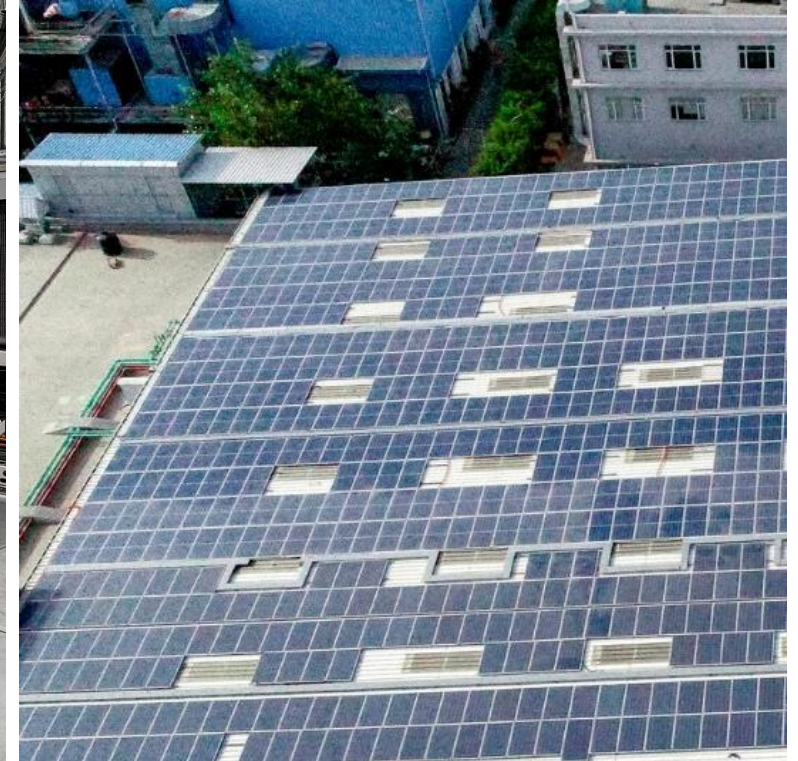
Nachhaltige Energiequellen Gesamte photovoltaische Kapazität bei kWp 1'224 Solarzellen bei Bucher Hydraulics in Indien
