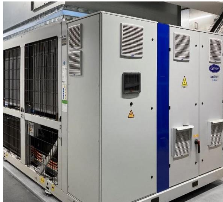
Kälteanlage von Kuhn Group, Saverne
